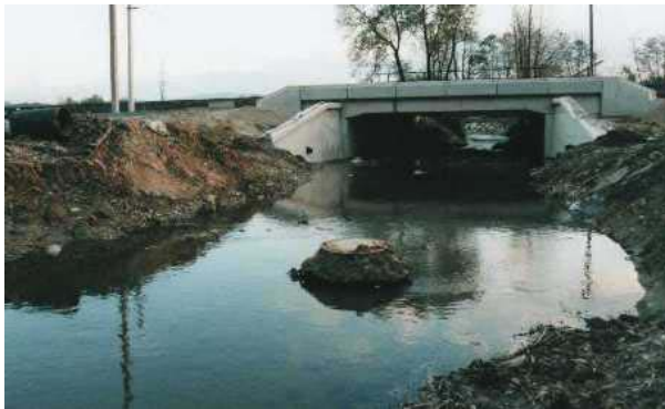
Kanaldeckel mitten im Fluß
