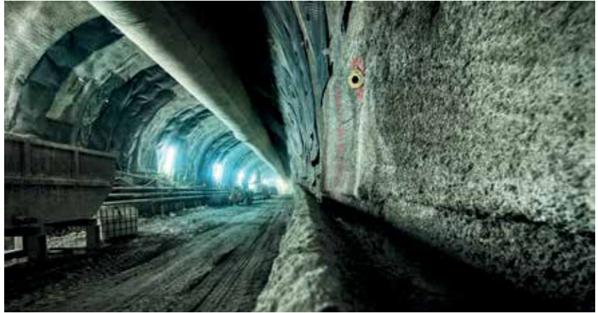
Im Tiefbau arbeiten Maschinen laut Dominik Dam, Zeppelin, bereits selbstständig über Remote Control. In Minen werden autonom fahrende Muldenkipper ebenfalls schon eingesetzt.
