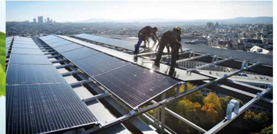
Wien baut Solarkraft auf eigenen Gebäuden massiv aus, vom Krankenhaus bis zur Sportstätte. Das Potenzial wird auf bis zu 8 Megawatt Leistung geschätzt. Mitte Juni erfolgte der Startschuss für die Solar-Offensive.
