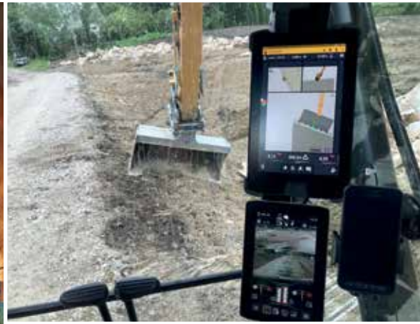
Der Einsatz von Kameras, Sensoren und anderen Datenerfassungstechnologien zur Realitätserfassung und Visualisierung der Baustelle ermöglicht die zentimetergenaue Umsetzung des digitalen Modells.
