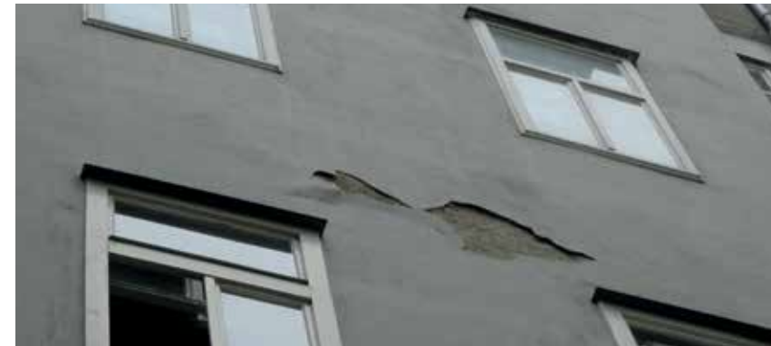
Einer der häufigsten Mängel im mehrgeschoßigen Wohnbau trifft den Bereich Fassaden, speziell bei Hauptgesimsen.
